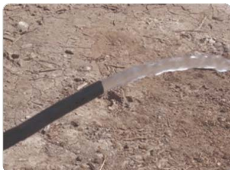
Fotografía 4: Lavado de la red de riego con eliminación del agua y fin de laterales.
