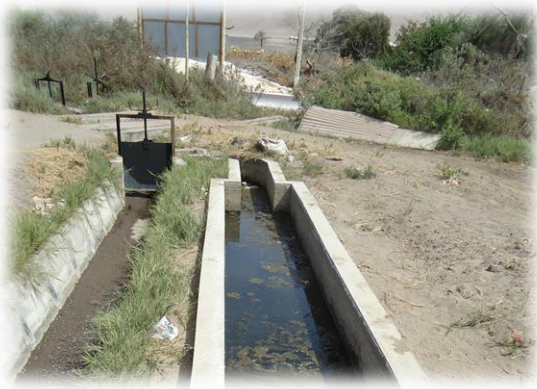
Figura 1. Desarenador en predio ubicado en el Valle de Lluta.
