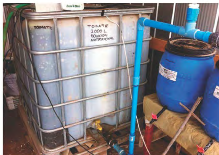
Figura 1: Sistema de riego consistente en dos estanques de 1.000 litros para preparar la solución de riego, un programador, bomba impulsora y tambores con soluciones concentradas.
