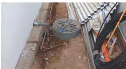
Foto 11: Sistema de alcantarillado.
