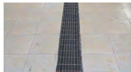
Foto 10: Sistema de recepción de riles "sumidero".
