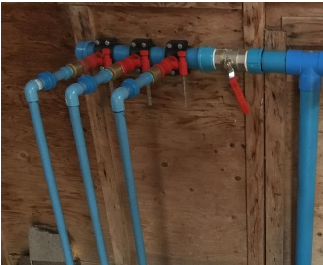
Figura 1. Inyectores Venturi utilizados en un sistema de riego.
