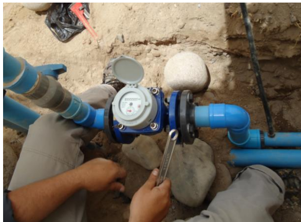
Figura 1. Contador volumétrico en predio ubicado en sector Sobraya, Valle de Azapa.
