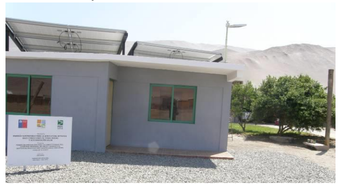
Figura 3. Proyecto fotovoltaico km 21, Valle de Azapa.
