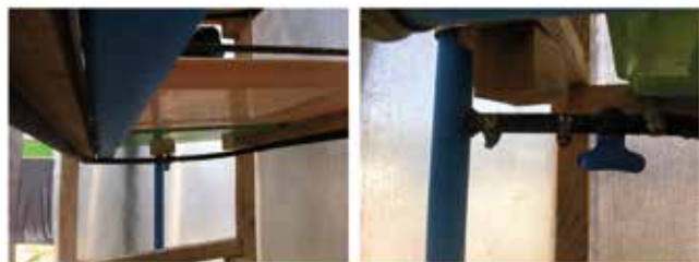
Figura 7 y 8. Disposición de tuberías de polietileno utilizadas para la conducción del agua hacia los emisores.
