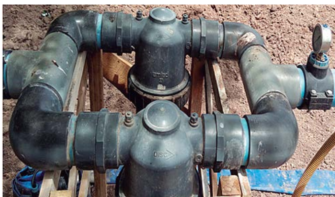
Foto 6. Filtro bien instalados con manómetros.
