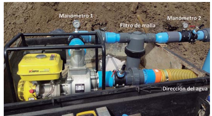
Foto 1. Sistema de succión y filtrado sobre un carro de arrastre.
