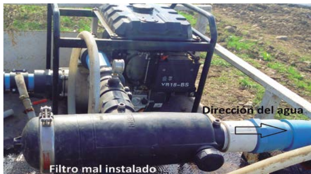
Foto 5. Filtro de anillos en posición incorrecta.
