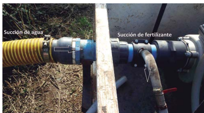
Foto 7. Conexión de la manguera de inyección de fertilizante.
