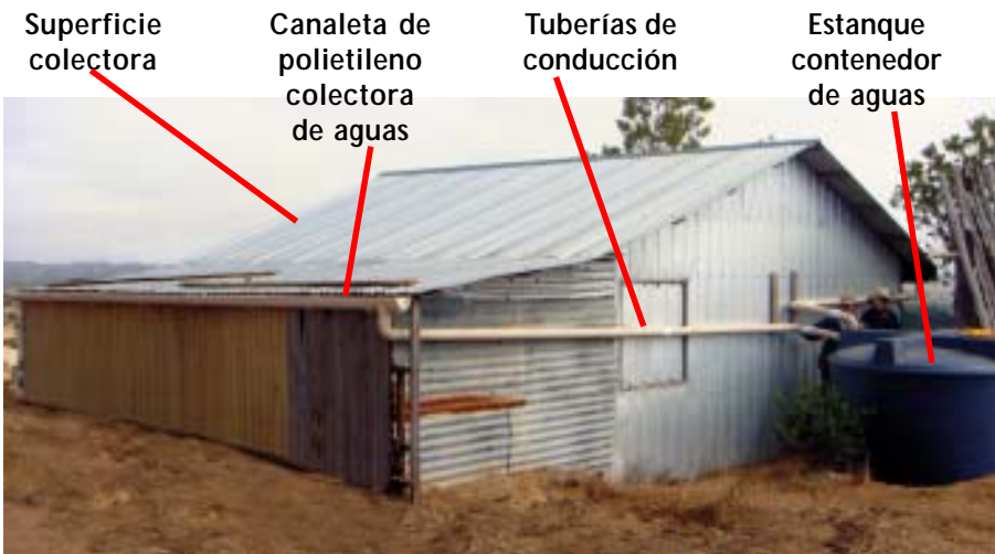
Foto 7. Identificación de los componentes de un sistema colector de aguas lluvias a través del techo de una casa.
