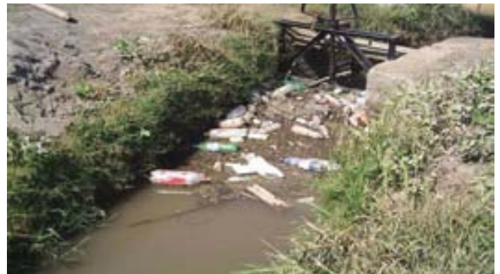
Canal de riego con presencia de basuras depositadas en el fondo.
