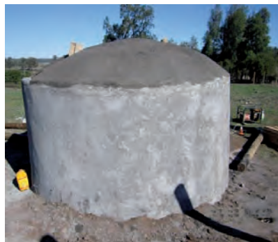
Foto 1. El diseño cilíndrico de la cisterna, facilita una gran resistencia a la presión del agua.
