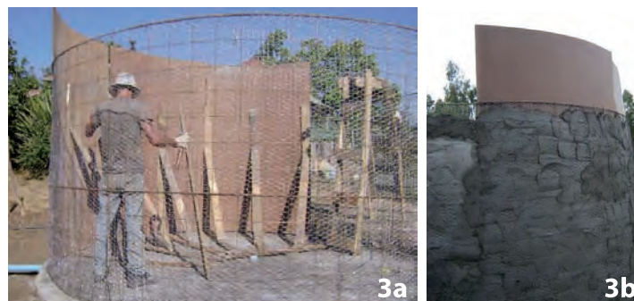
Foto 3. (3a y 3b). Instalación del cimbrado para el revestimiento de la cisterna y aplicación de la primera mano de mezcla de arena y cemento exterior.
