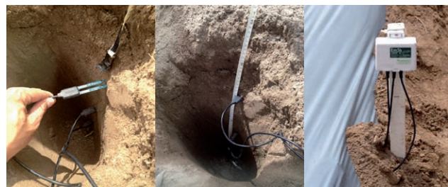
Foto 2. Instalación sonda de humedad EM5b (Data collection system).
