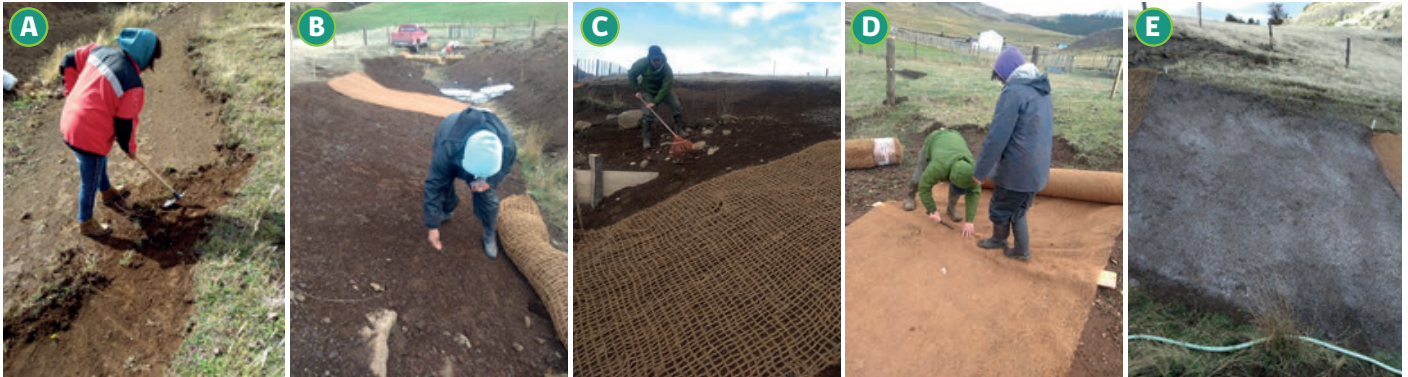
Figura 2 A: “Peinado de la cárcava” para eliminar bordes degradados. B: Siembra y fertilización al voleo. C: Siembra y fertilización al voleo, más protección con geomalla. D: Siembra y fertilización al voleo, más protección con geomanta. E: Hidrosiembra en ladera erosionada de la cárcava.
