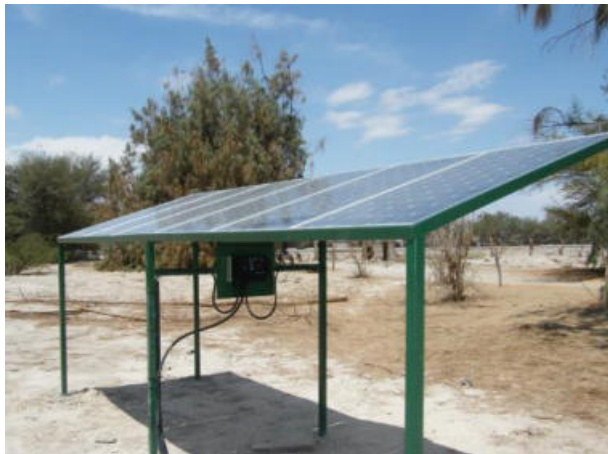
Figura 7: Generador solar, instalación fija con estanque de acumulación
