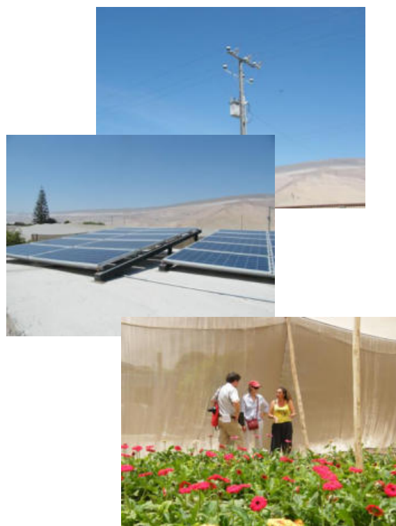
Figura 9: Sistemas fotovoltaicos con conexión a red
