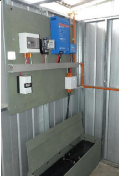
Figura 5. Caseta con paneles, tablero eléctrico con inversor y banco de baterías
