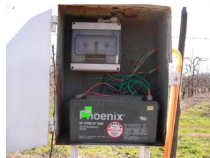
Foto 2. Panel de control
