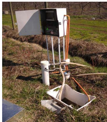
Foto 1. Equipo divisor de agua
