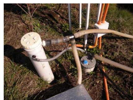
Foto 4. Tubos divisores de agua
