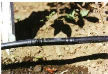
Figura 1: Riego por goteo, (gotero en línea)
