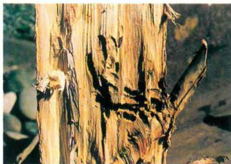
Foto N° 4. Galerías de Ch. valdiviana en fuste de E. nitens (Foto: M. Donoso)
