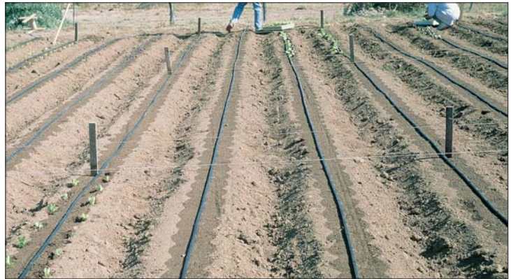
Preparación de mesas en instalación del riego tecnificado para siembras en túnel.
