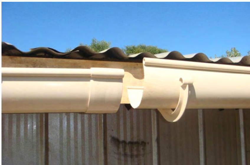
Figura 6. Unión de canaletas en altura, para facilitar montaje.
