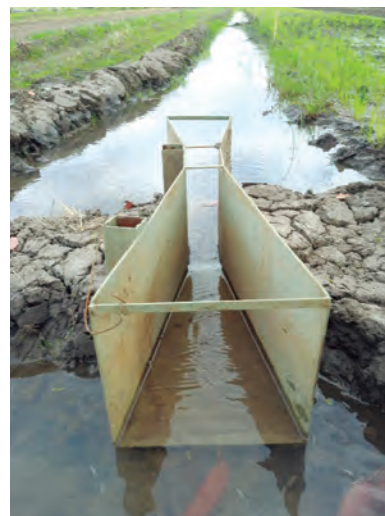
↑ Figura 2. Canaleta Parshall instalada en 4 ensayos de San Carlos y 4 de Parral. Cada canaleta tiene un Sensor HOBO U20 para medición automática y almacenaje de datos de nivel de agua, para cálculo de caudal.
