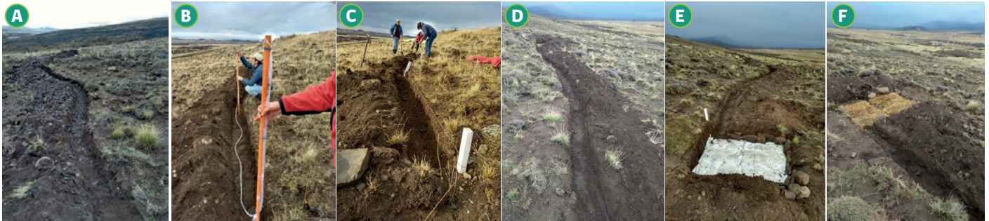
Figura 2 A: Canal de desviación construido siguiendo las curvas de nivel. B Determinación de curvas de nivel en terreno, para construcción del canal de desviación. C: Estacada para marcar el trazado del canal de desviación. D: Acumulación de material pendiente abajo del canal de desviación. E: Zona de descarga construida con sacos rellenos de tierra. F: Zona de descarga construida con fardos de paja.
