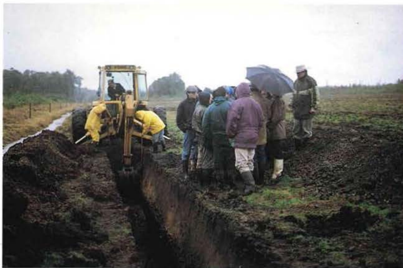
Construcción de una zanja colectora en el predio del Sr. Otto Kush (Quillanto).
