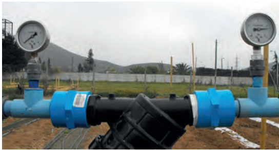
Figura 11.22. Manómetros ubicados a la entrada y salida del filtro de malla. Al existir una variación de presión, indica un posible taponamiento, por lo cual se debe limpiar el filtro.
