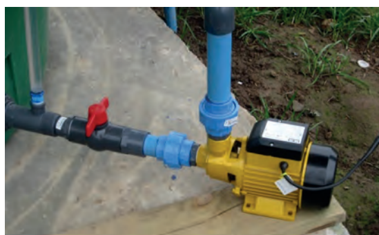
Figura 11.8. Bomba conectada a estanque acumulador.
