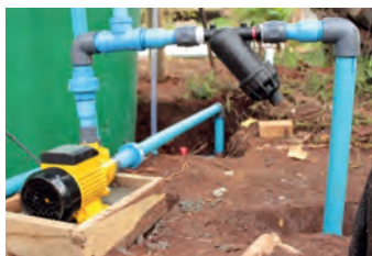
Figura 11.11. Filtro de malla en instalaciones del proyecto.
