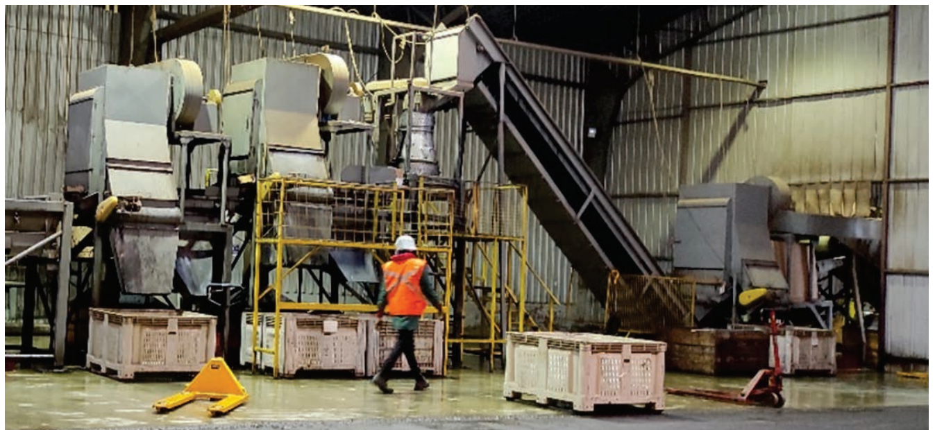
Figura 1. Vista general de un planta de proceso.
