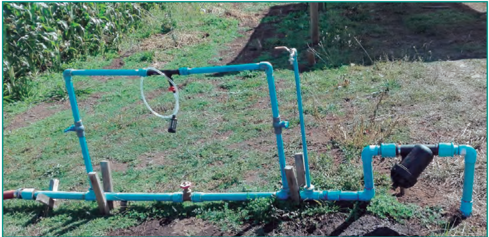
Figura 18. Sistema de fertirrigación que se muestra el Inyector Venturi, instalado a metros del inicio de la siembra
