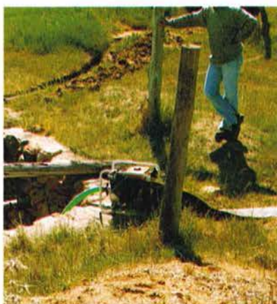
Motobomba con tubería corrugada para la succión del agua y una manga para conducir lejos del pozo el agua extraída.
