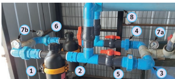
Figura 1. Componentes de una batería de dos filtros de retrolavado manual.
