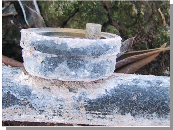
Fig.1. Obstrucción por causada por carbonatos
