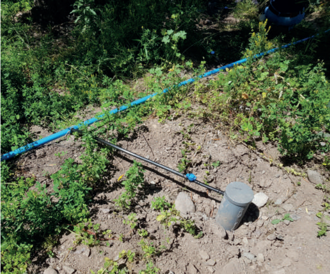
Figura 11. Tubo vertical 110 mm, tubería de polietileno conectada a matriz PVC de 32 mm.
