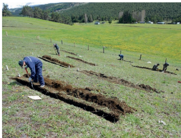
Figura 1: Zanjias de infiltración construidas en curvas de nivel, Cuesta Alvarado, región de Aysén
