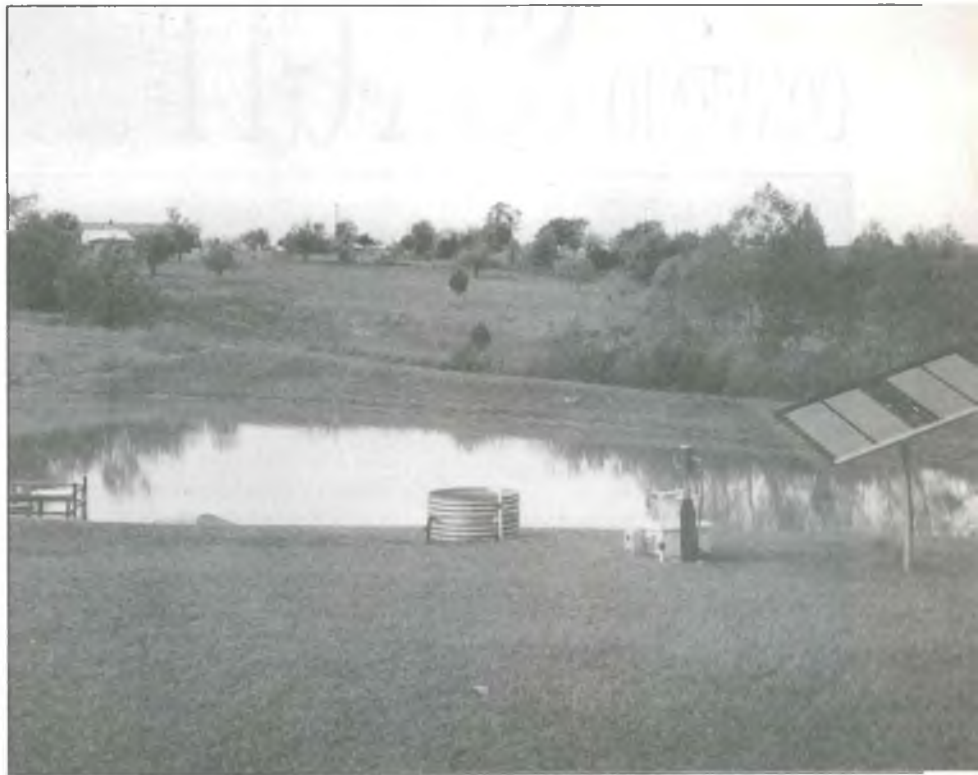
Energía fotovoltaica para elevación de agua.
