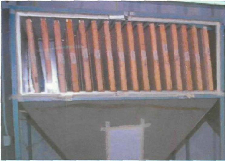
Foto 5. Parte superior de caja de emergencia.
