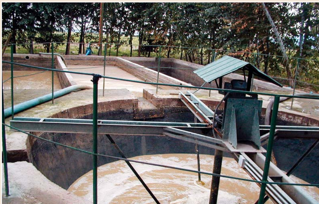
Pozo de eculización y homogeneización de purines.
