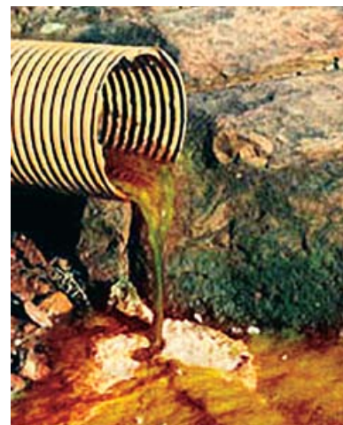
Foto 9. Descarga de aguas servidas
