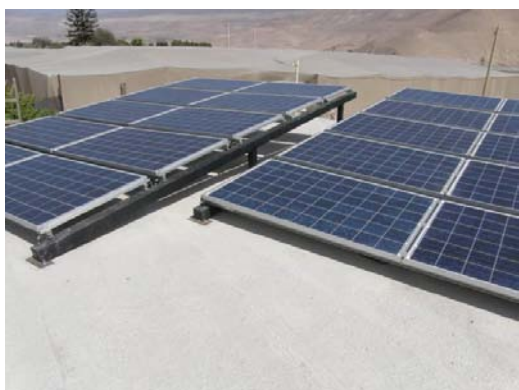
Figura 7. Generador fotovoltaico de 5 kWp emplazado en el km 21 del Valle de Azapa. Fuente: INIA Ururi (2016).
